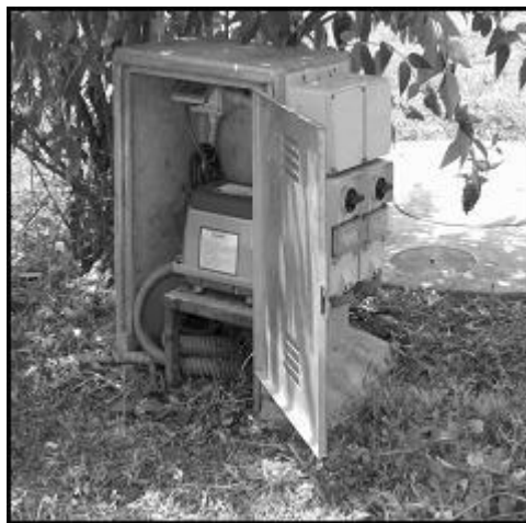
ESEMPIO DI LOCALE TECNICO
