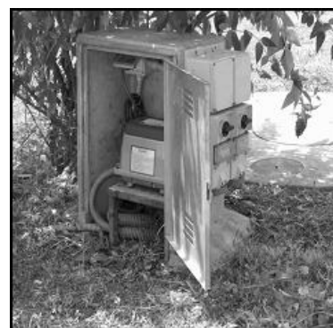
ESEMPIO DI LOCALE TECNICO
